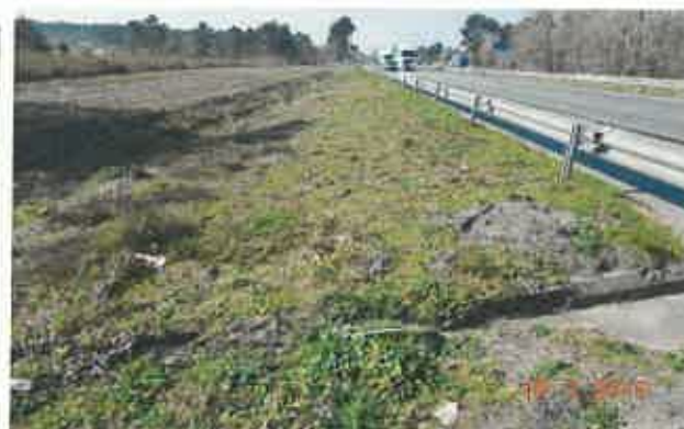
Dalot d'évacuation d'eau pluviale de la plateforme A63 vue vers le SO
