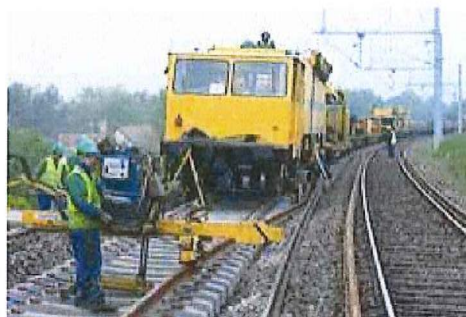
Longs Rails soudés sur traverses béton
