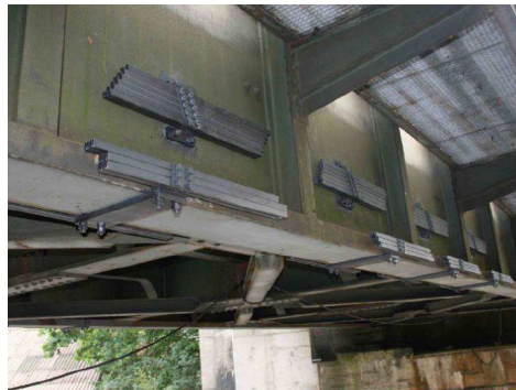
Absorbeur sur platelage
