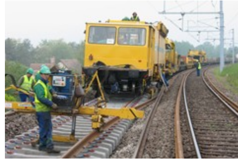
Longs Rails soudés sur traverses béton
