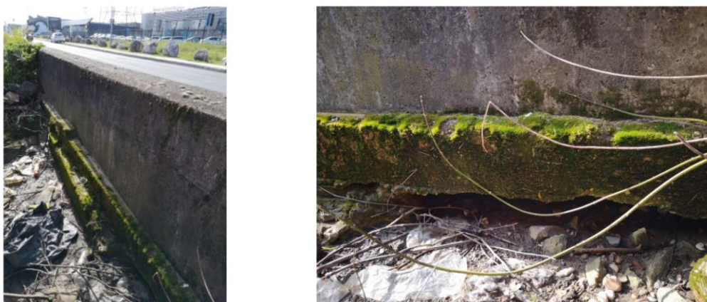
Vues des affouillements en pied de muret côté Garonne
