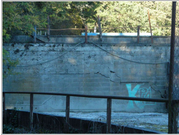
Usine KP1 au niveau d'une plate-forme de stockage et de manutention, on notera la fissuration avancée du mur, caractéristique d'un affaissement du sol.
