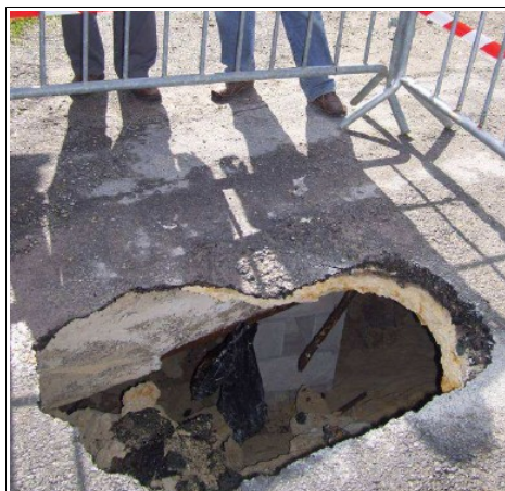
Fontis survenu sur la voie communale n° 17, on notera la faible épaisseur de cerveau de la carrière (environ 70 centimètres).
