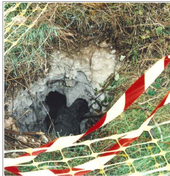
Gros plan sur le fontis, on distingue la canalisation de gaz au fond du trou (partie sombre).
