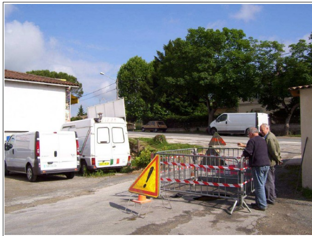
Fontis au lieu-dit Au Prieur, sous la voie communale n° 17.
