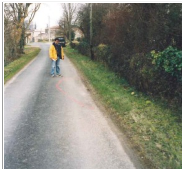
Affaissement de la voie communale n° 4 (marque rouge au sol). Cette voirie est aménagée au dessus d'une cavité déjà frappée par des mouvements de terrain souterrains.
