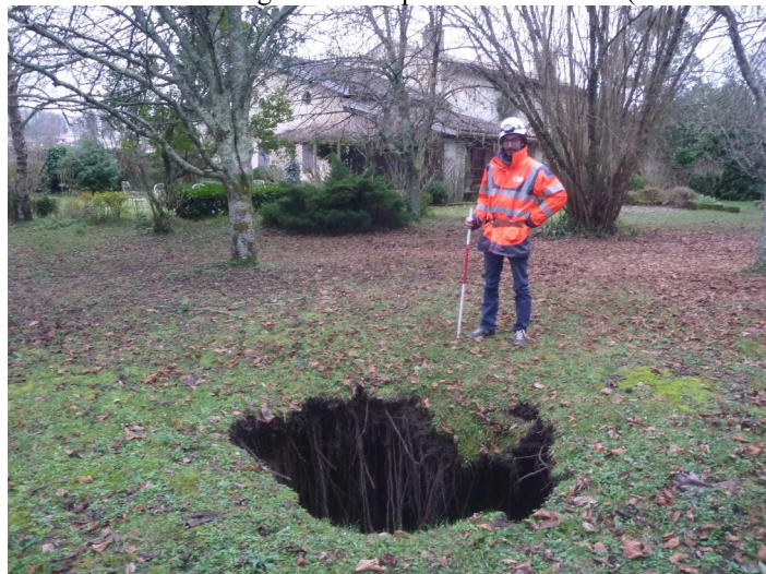
Fontis du 27 janvier 2018, lieu-dit « Sayes ».
