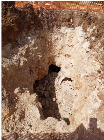
Effondrement survenu au lieu-dit « Les Courtines »
