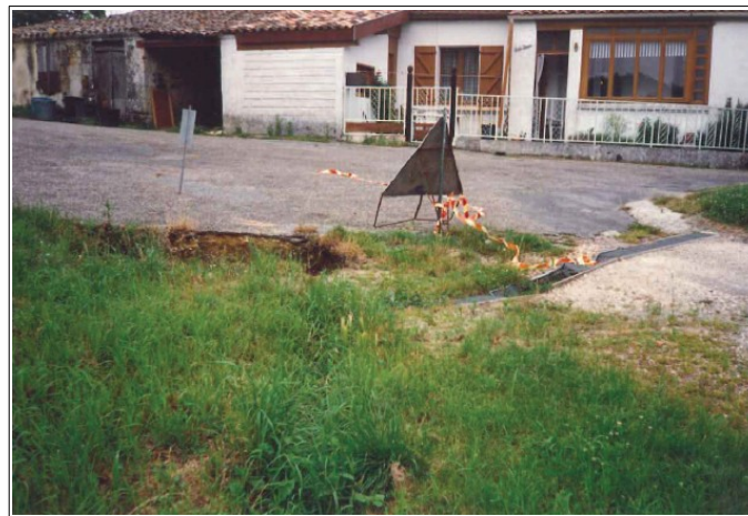
Fontis de 1990 et 1993 au niveau de la voie communale 11, la carrière en cause est décrite comme dangereuse.
