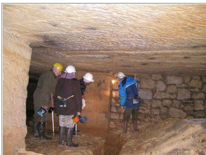
En sous-sol, approche de la zone effondrée (zone barrée par un mur en pierres maçonnées).
