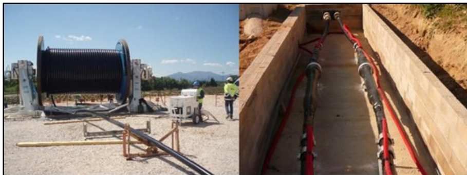
Touret de câbles et chambre de jonction
